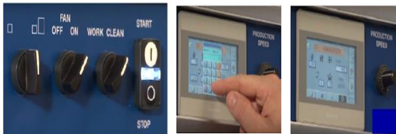
Foto 3 - Panel de Control
