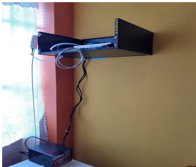
Imagen 18. Ubicación actual de los equipos de comunicación Fuente [Propia]
