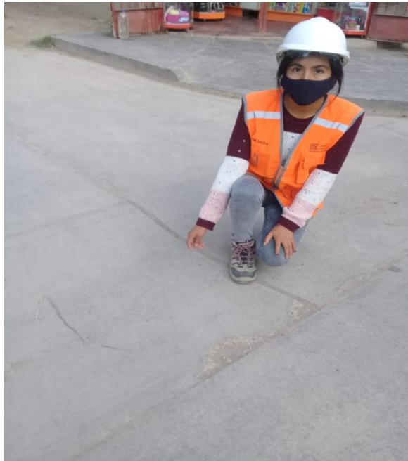
Se muestra una grieta en la esquina en la progresiva 0+220 en el margen Derecha de la calle Andrés Avelino Cáceres
