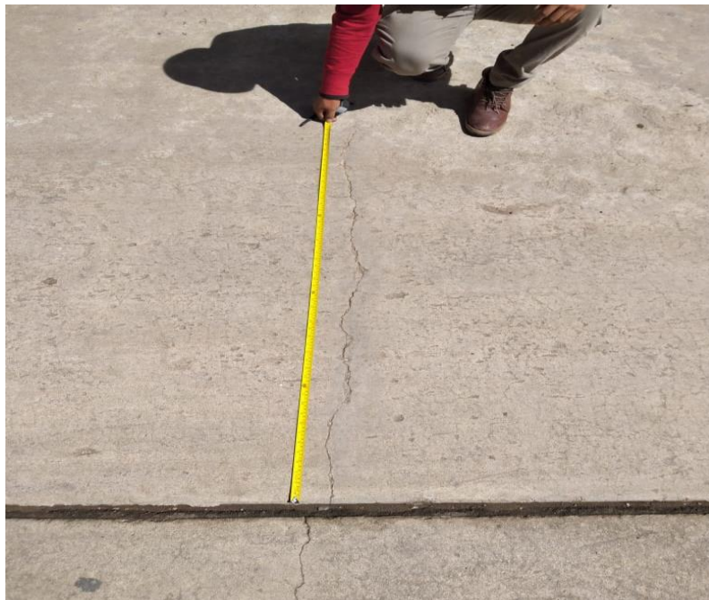
Se aprecia una grieta transversal en la progresiva 0+315 en la calle Andrés Avelino Cáceres.
