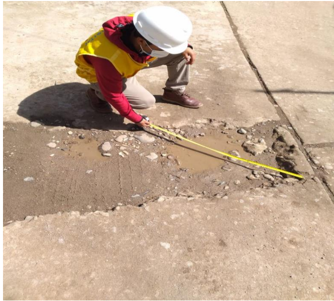
Se hace la medición del bache pronunciado encontrado en la Progresiva 0+236 en la calle Andrés Avelino Cáceres
