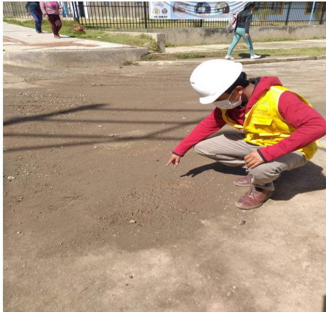
Se aprecia un severo bache en la progresiva 0+300 en la calle Andrés Avelino Cáceres
