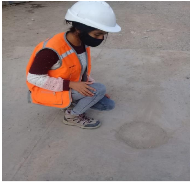
Se aprecia un bache regular ubicado en la progresiva 0+090 en la calle casa blanca.
