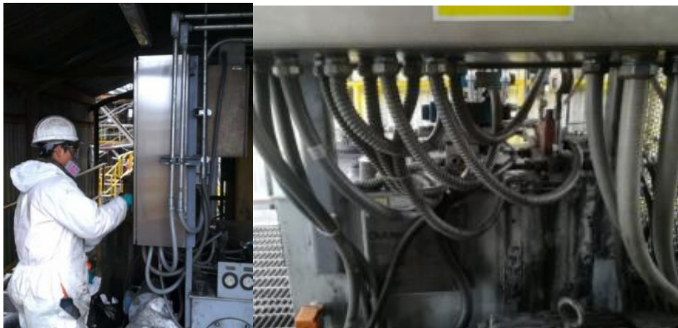
Fuente: Fotografía de cableado en estaciones de bombeo en SMEB
