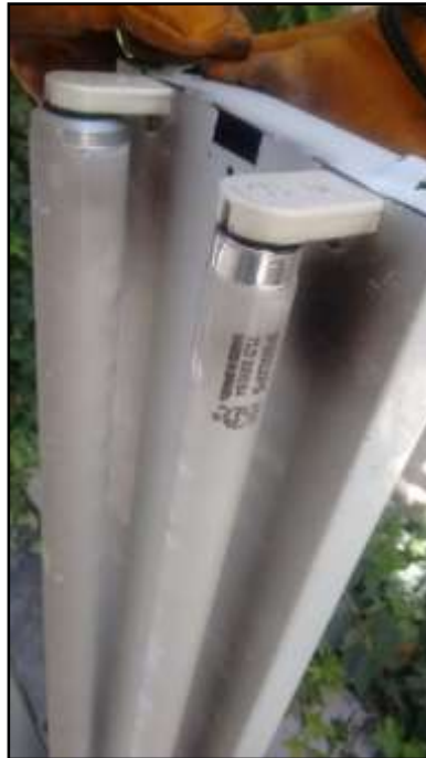
Figura 14. Observación en el equipo de iluminación N°10 Fuente: Elaboración propia.
