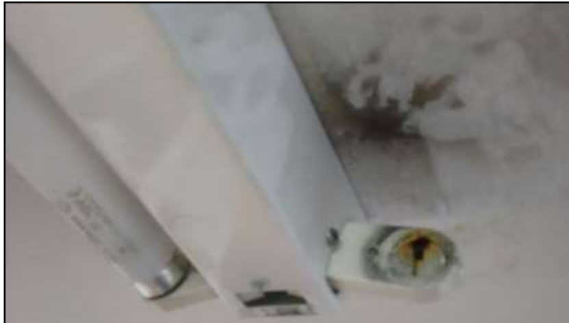
Figura 12. Observación en el equipo de iluminación N°8. Fuente: Elaboración propia.
