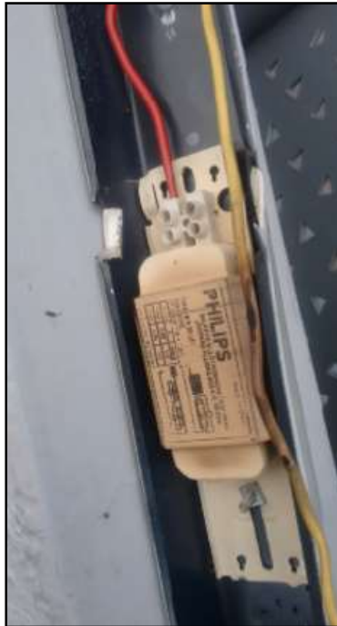
Figura 5. Observación en el equipo de iluminación.N°1. Fuente: Elaboración propia.
