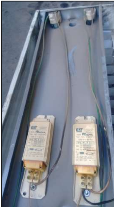
Figura 9. Observación en el equipo de iluminación N°5. Fuente: Elaboración propia.
