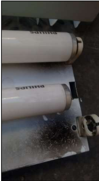
Figura 7. Observación en el equipo de iluminación N°3. Fuente: Elaboración propia.
