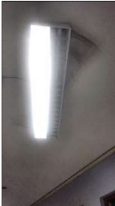
Figura 10. Observación en el equipo de iluminación N°6. Fuente: Elaboración propia.
