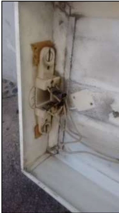
Figura 11. Observación en el equipo de iluminación N°7. Fuente: Elaboración propia.
