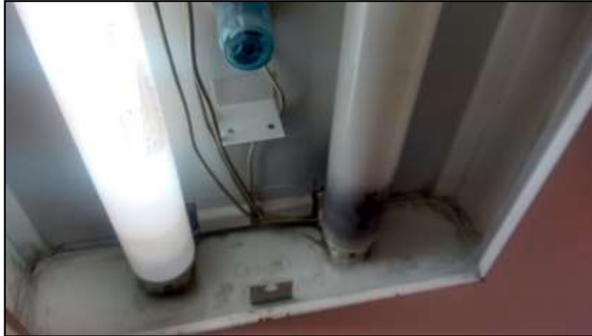
Figura 19. Observación en el equipo de iluminación N°15. Fuente: Elaboración propia.
