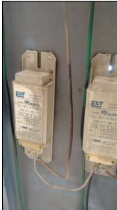
Figura 16. Observación en el equipo de iluminación N°12. Fuente: Elaboración propia.
