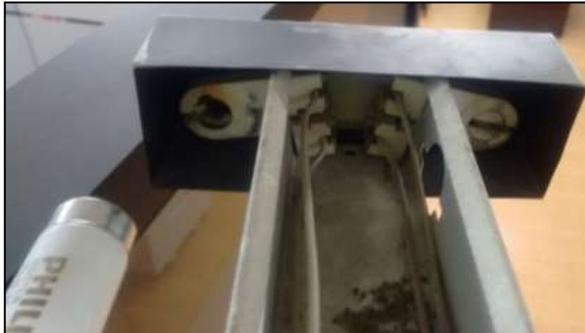
Figura 13. Observación en el equipo de iluminación N°9. Fuente: Elaboración propia.
