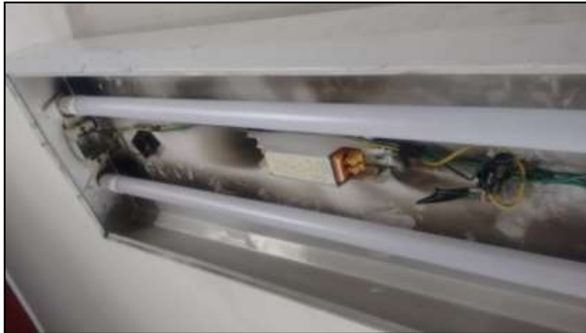
Figura 17. Observación en el equipo de iluminación N°13. Fuente: Elaboración propia.
