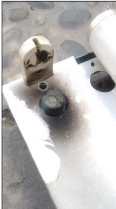
Figura 8. Observación en el equipo de iluminación N°4. Fuente: Elaboración propia.
