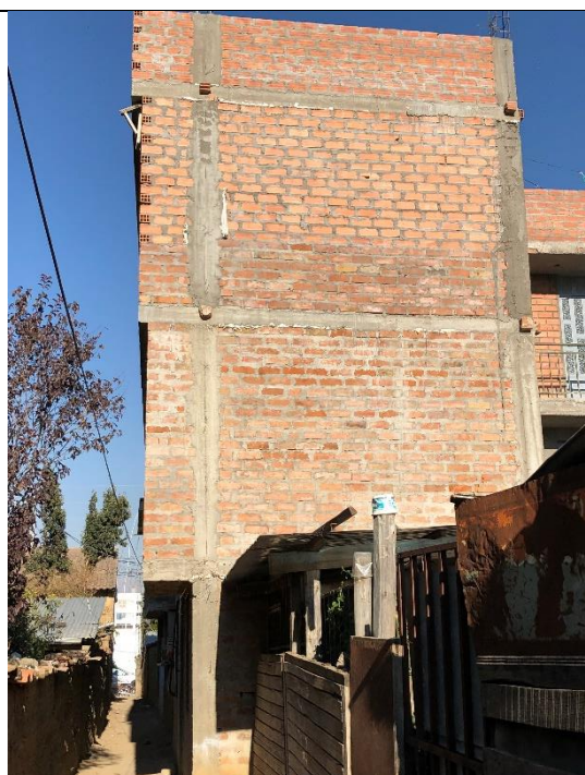
Figura 11. Vivienda con empleo de ladrillos artesanales en los dos primeros niveles y ladrillos tubulares en el último nivel, ubicación: Jr. Castilla, Palian.
