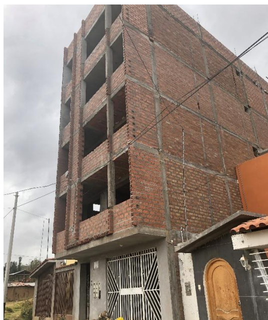
Figura 9. Vivienda con empleo de ladrillos industriales en los tres primeros niveles y ladrillos tubulares en los últimos niveles, ubicación: Urb. Sol de los Andes.
