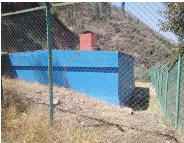
Figura 27. Foto del sistema de Captación 3 Pucuyuyoc.
