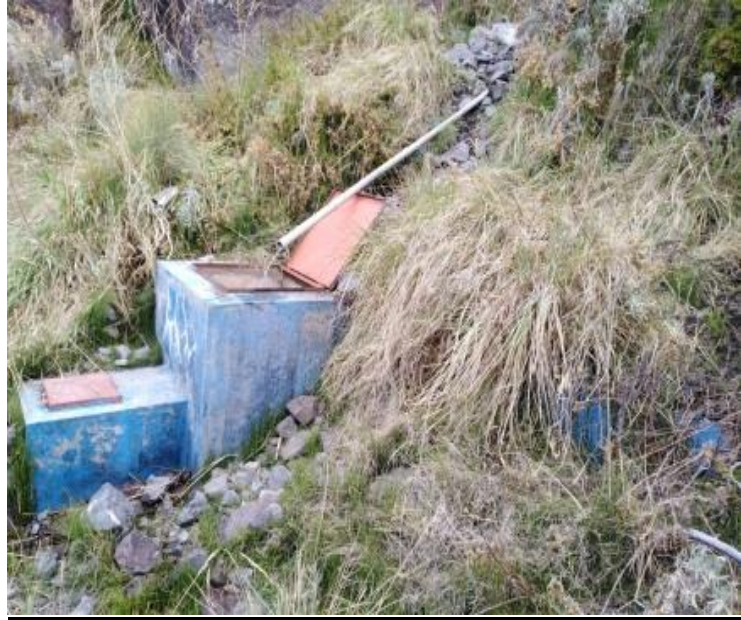
Figura 35. Foto del sistema de Captación 5 Ccorihuayrachina.
