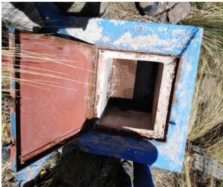
Figura 31. Foto del sistema de Captación 1 vista interior Ccorihuayrachina.
