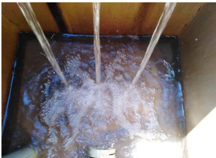
Figura 26. Foto del sistema de Captación 2 Pucuyuyoc.
