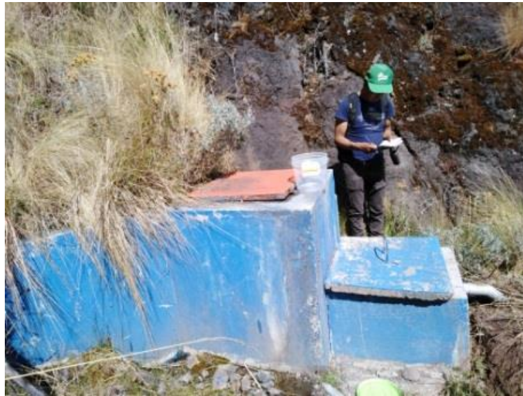
Figura 34. Foto del sistema de Captación 4 Ccorihuayrachina. Fuente: Municipalidad Distrital de San Salvador. Recuperado de la ATM
