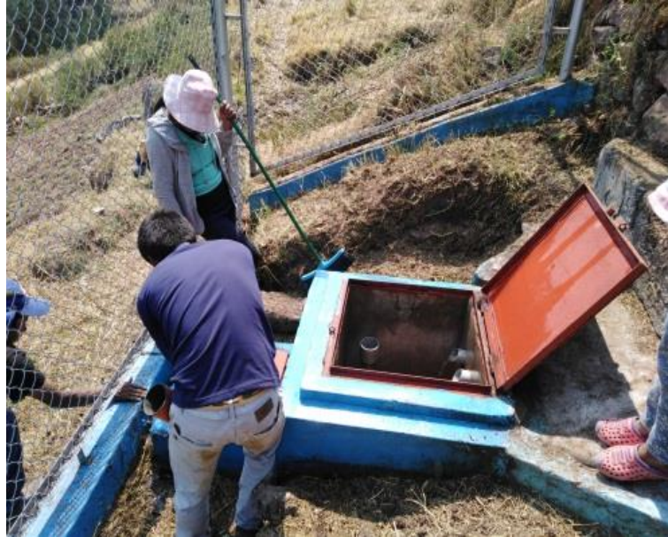
Figura 28. Foto del sistema de Captación 4 Pucuyoc. Fuente: Municipalidad Distrital de San Salvador. Recuperado de la ATM
