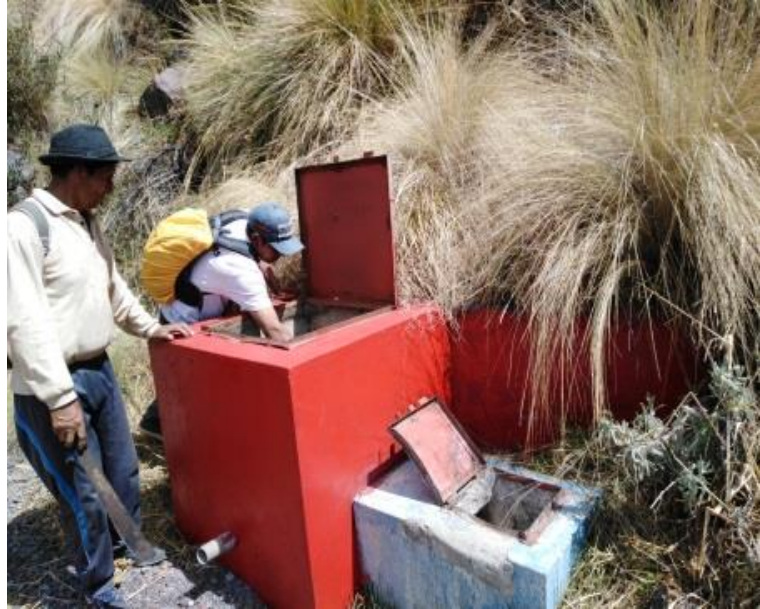
Figura 33. Foto del sistema de Captación 3 Ccorihuayrachina. Fuente: Municipalidad Distrital de San Salvador. Recuperado de la ATM
