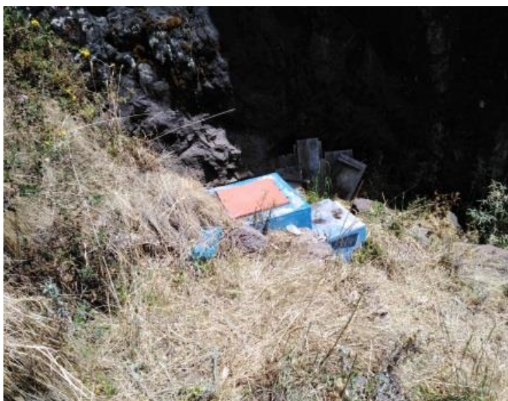
Figura 32. Foto del sistema de Captación 2 Ccorihuayrachina.
