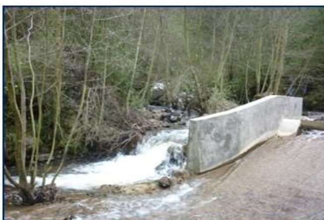
Fotografía 03. Estructuras de regulación del caudal, a medida que se orientan las aguas a un nivel menor.
