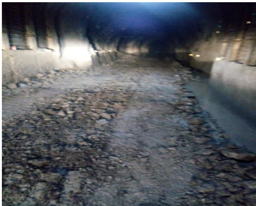
Figura 36. Rampa principal RPA. 3570 en malas condiciones
