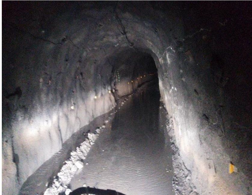
Figura 35. Rampa principal RPA. 696 (veta 27) en malas condiciones
