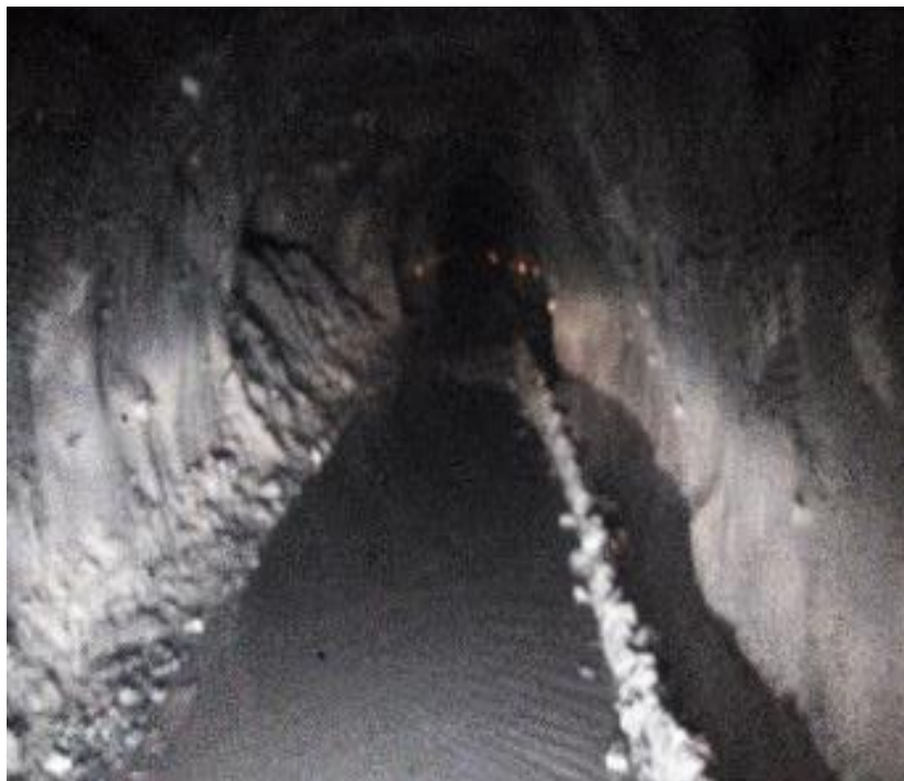
Figura 34. Vía principal CRO. 456 en malas condiciones
