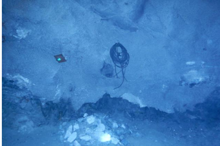
Figura 32. Hormigón proyectado descalzado
