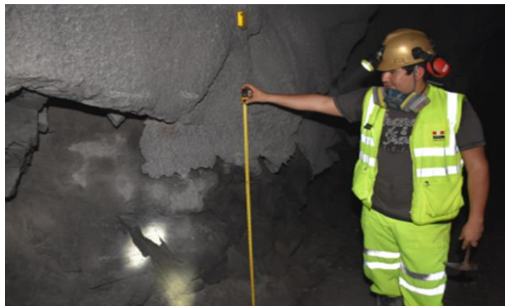
Figura 33. Hormigón proyectado descalzado
