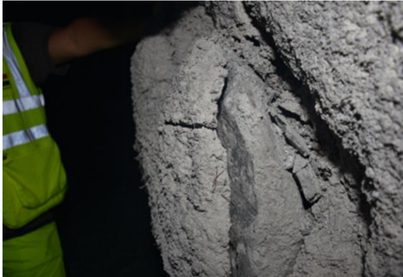
Figura 30. Fallo de adherencia
