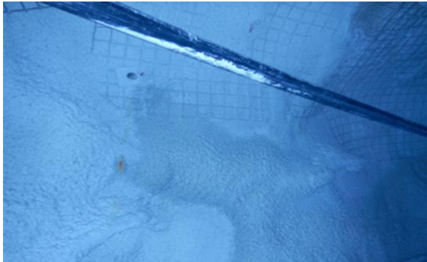
Figura 36. Hormigón proyectado mal compactado
