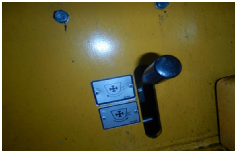
Figura 31. Agitador en posición incorrecta durante el bombeo
