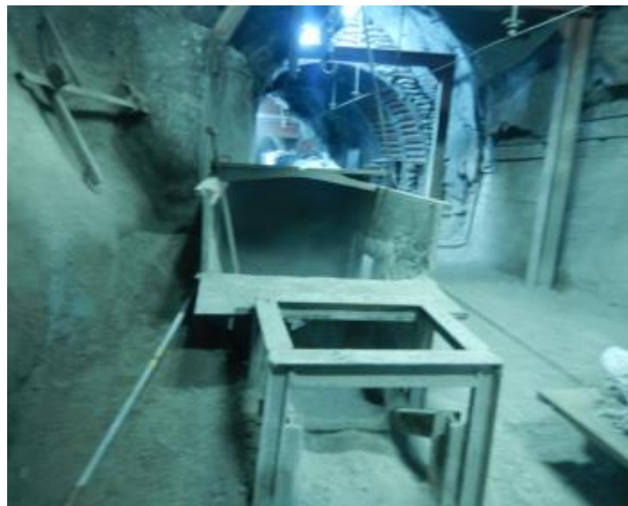
Figura 16. Tolva de carga silo de cemento
