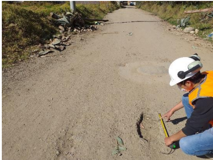
Figura 3. Presencia de baches en la carpeta asfáltica de la Av. Andrés A. Cáceres
