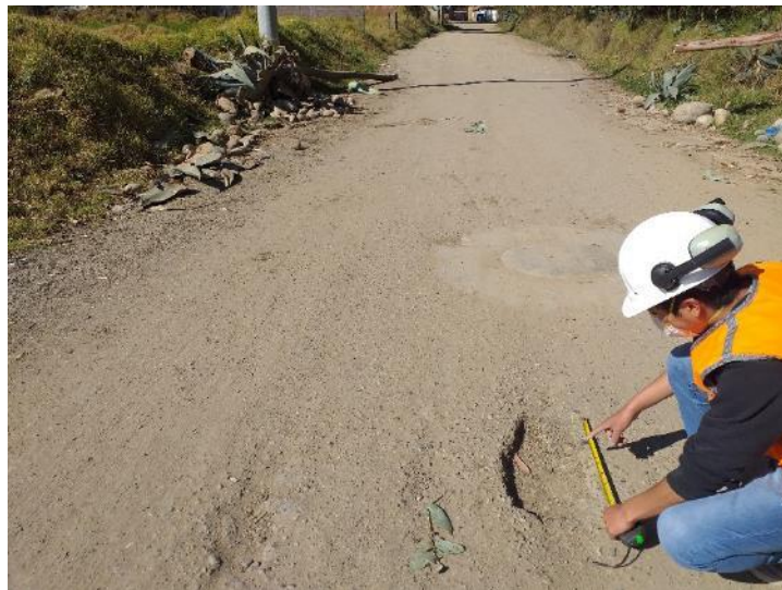
Figura 1. Deterioro de la carpeta asfáltica de la Av. Andrés Avelino Cáceres.
