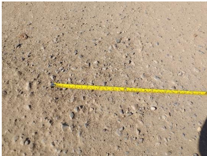
Figura 4. Desprendimiento de agregados de la carpeta asfáltica
