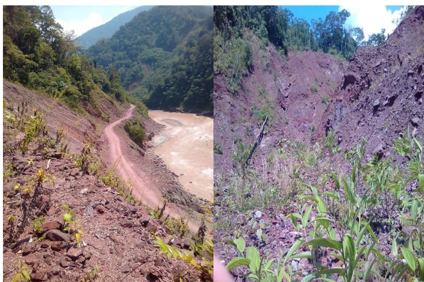
Figura 62: Situación actual del talud en estudio.
