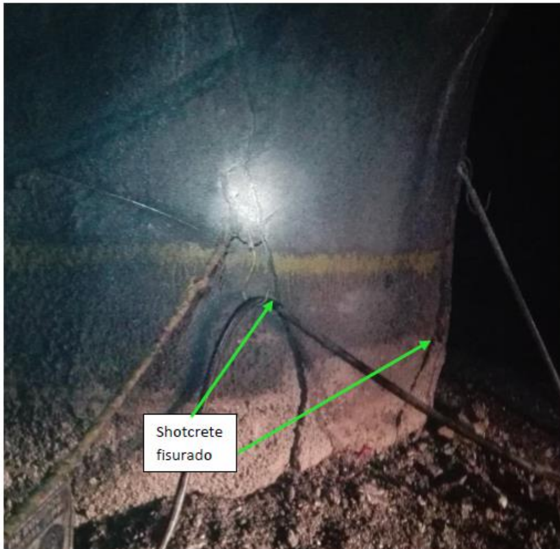
Figura 10. Fisuramiento del concreto lanzado "shotcrete" debido a condición de esfuerzos
