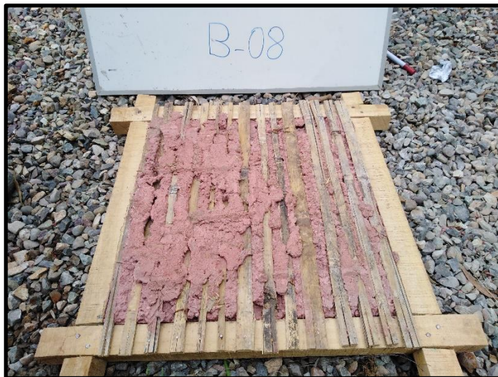
Ilustración 8: Panel B-08 de cañas en sentido vertical, presenta fisuras profundas y un agrietamiento vertical el mortero quedo adherido de manera dispareja la mezcla sobre paso las cañas, se usó una malla hexagonal de gallinero de media pulgada.
