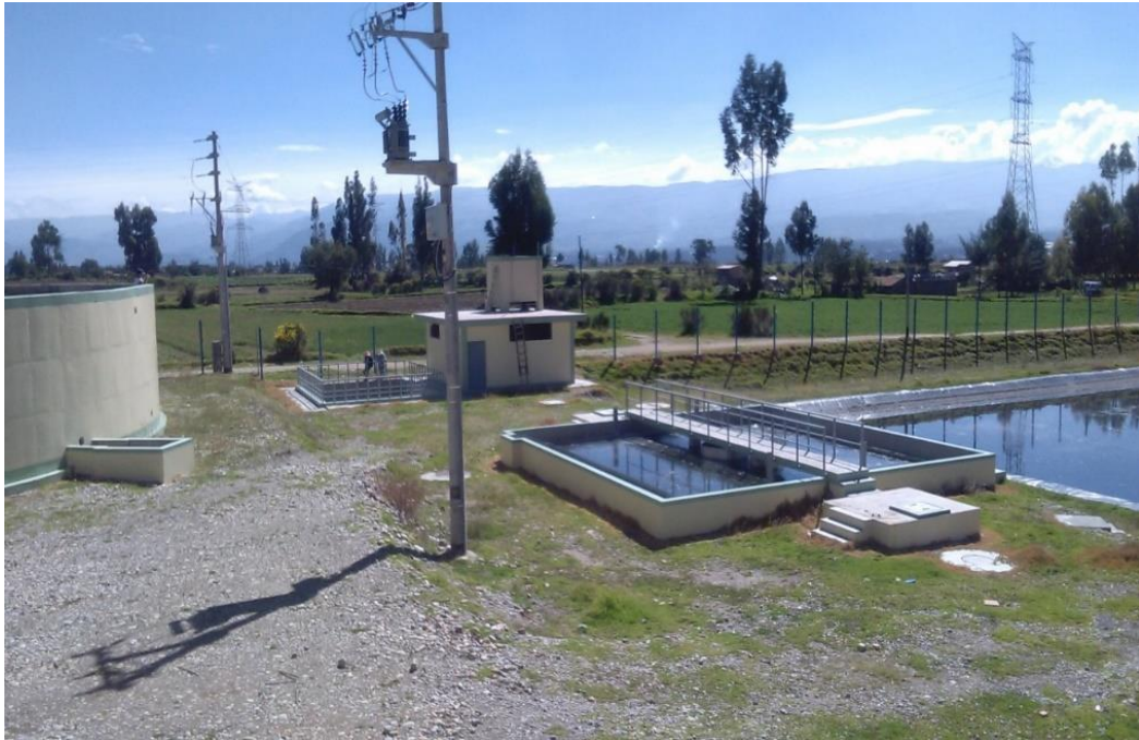
Fotografía 05. Planta de tratamiento de aguas residuales municipales de Chupaca - Junín.
