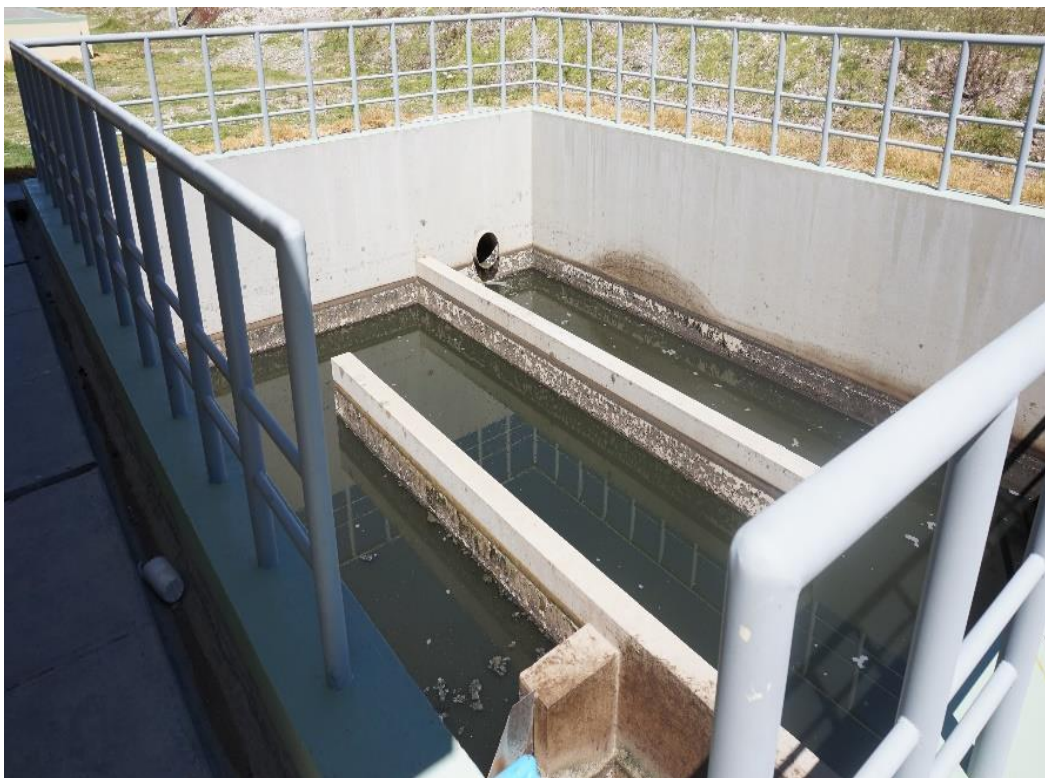
Fotografía 06. Sistema de tratamiento terciario con cloro de la planta de tratamiento de aguas residuales municipales de Chupaca - Junín.
