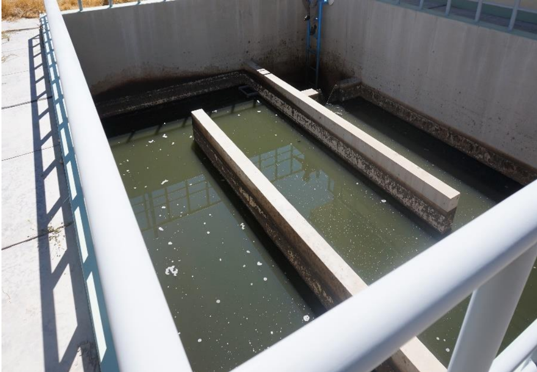
Fotografía 07. Alimentación del cloro en el tratamiento terciario de la planta de tratamiento de aguas residuales municipales de Chupaca - Junín.
