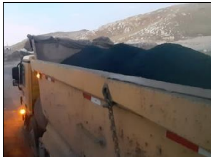
Figura 2. Llegada de la Mezcla Asfáltica a obra a temperatura por debajo de lo recomendado en el Distrito de Chupuro. Toma propia, 2020.
