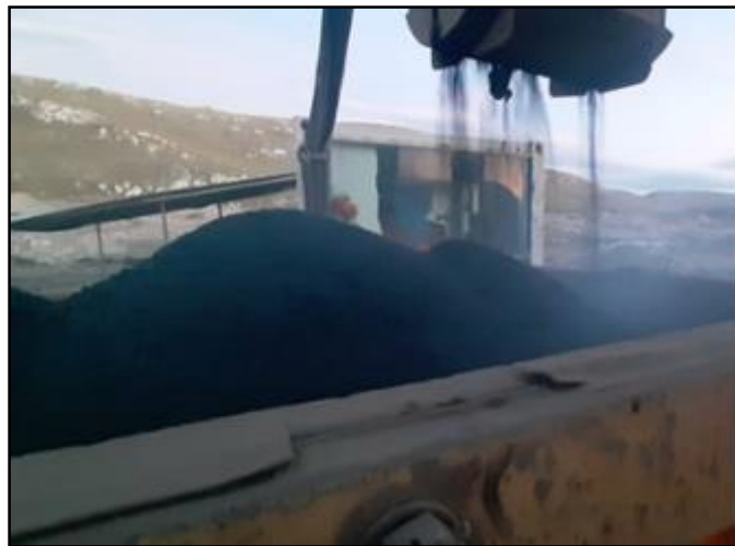
Figura 1. Salida de la Mezcla Asfáltica convencional ante problemática climática en el Distrito de Chupuro. Toma propia, 2020.
