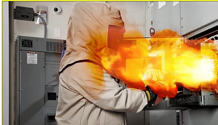
Figura 1: Arco eléctrico en la maniobra de un CCM
