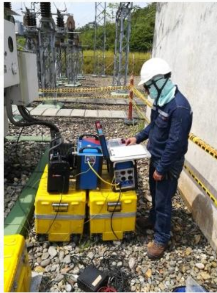
Figura 11. Mantenimiento en autotransformadores
