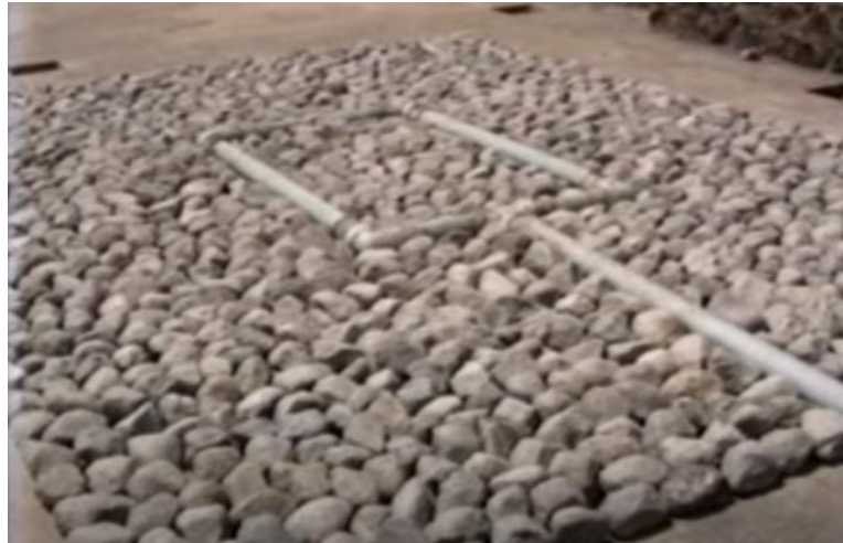
Figura 21. Cama de piedras e instalación de tuberías de aireación para las pilas.
