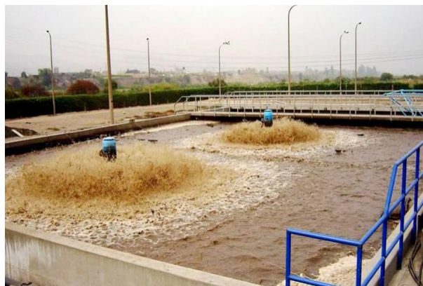
Figura 03. PTARD de lodos activos - Majes, Arequipa.
