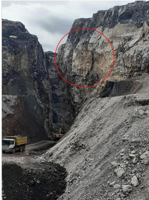
Figura 42. Desprendimiento de masa rocosa, debido a que su ángulo de reposo es superior a 90^{\circ}
