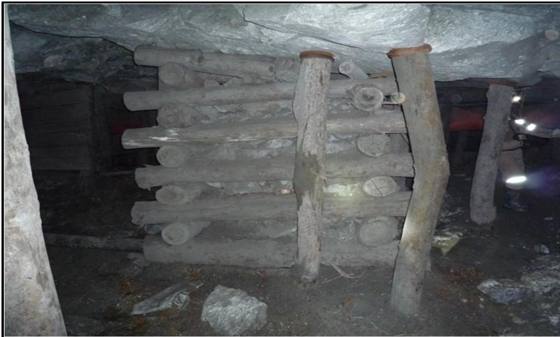
Figura 59. Sostenimiento con Wood Crib de 2x2 m, método de minado Long Wall
