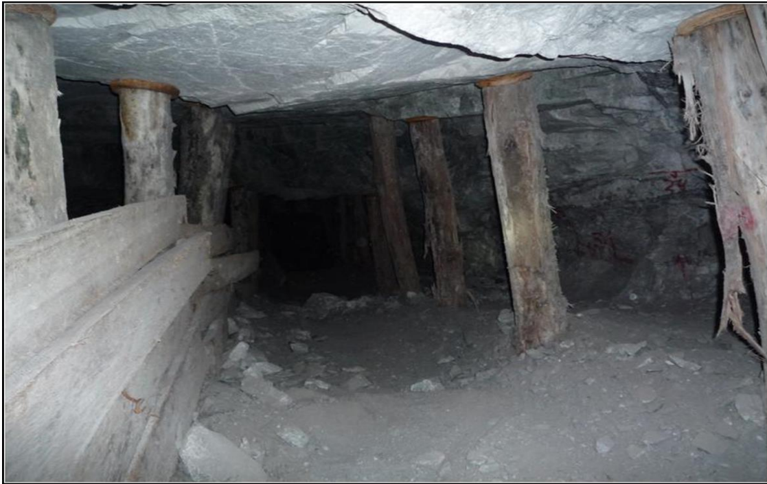
Figura 58. Entablado lateral para mantener el canal de rastrillaje del método de minado Long Wall
