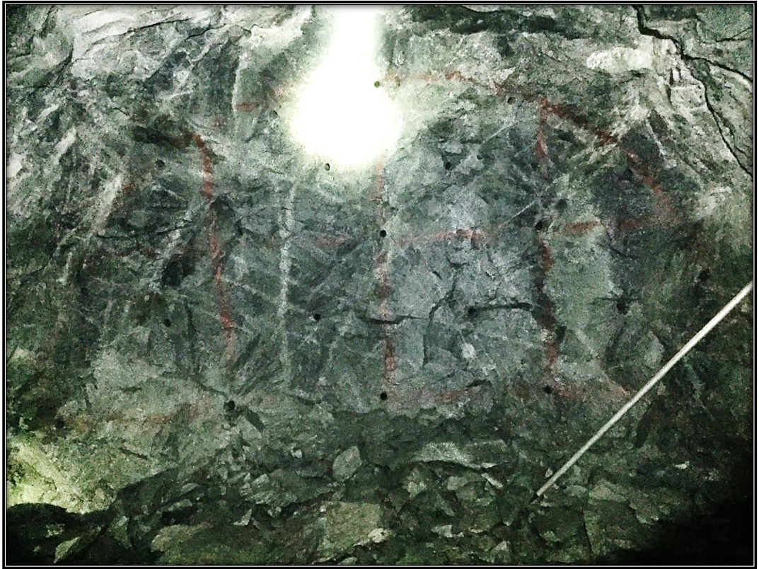
Figura 18: Fotografía del pintado de la malla propuesta, parte superior.
