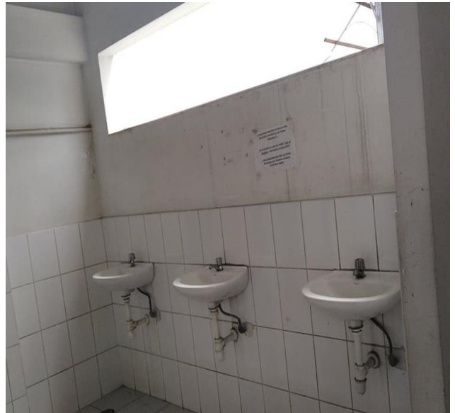
ESTADO DE LOS LAVABOS
