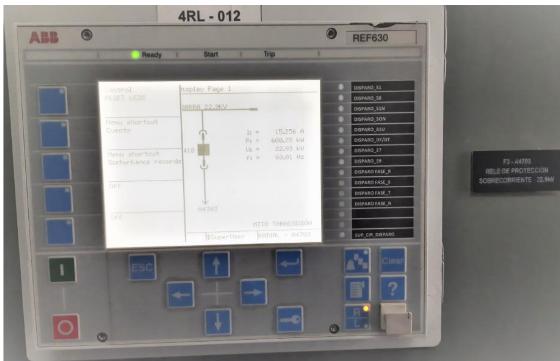
Figura 7: Relé de protección del alimentador A4703.
