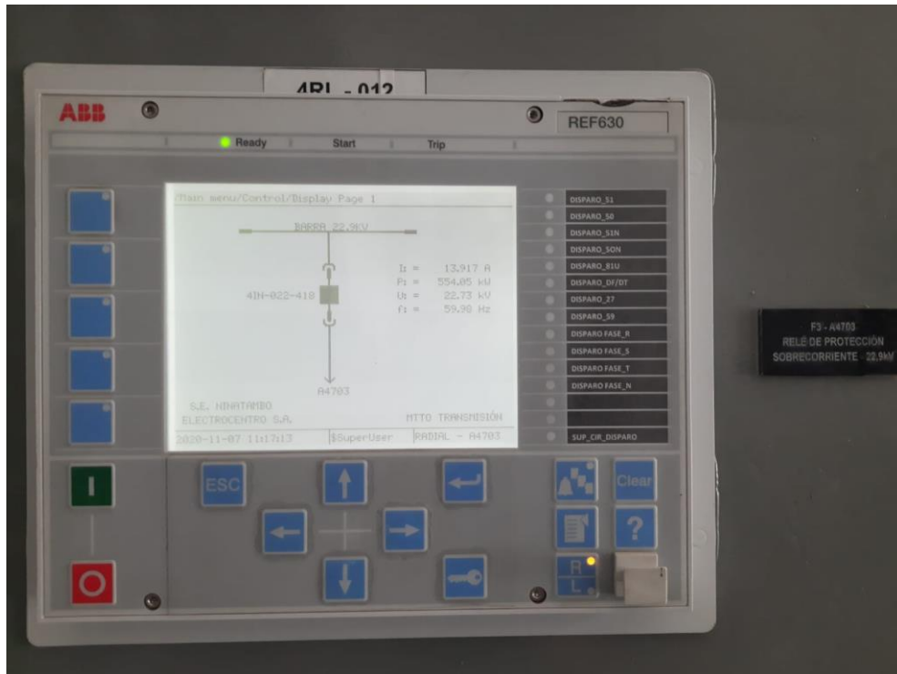
FOTO 4: Relé de protección del alimentador A4703.
