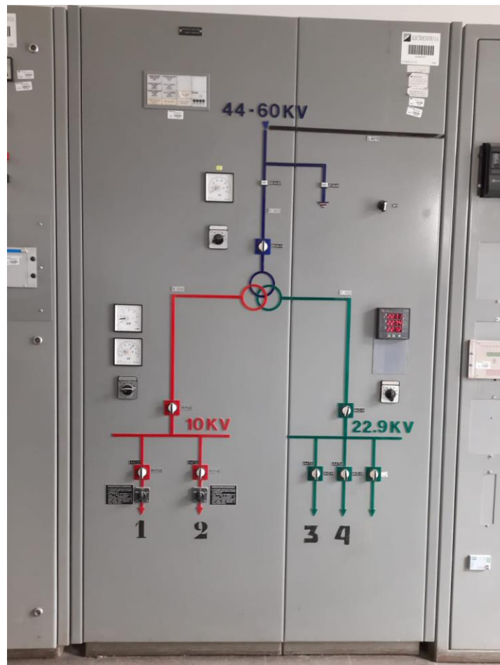
FOTO 2: Tablero de maniobra de la SET Ninatambo
