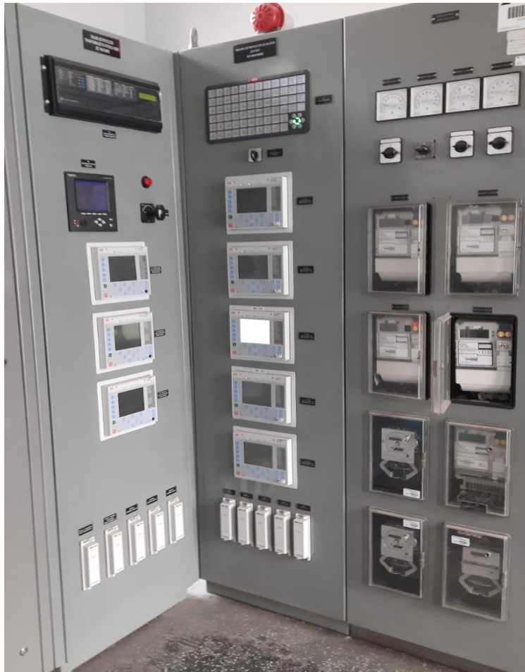
FOTO 3: Tablero de protección de salidas 22,9kV
