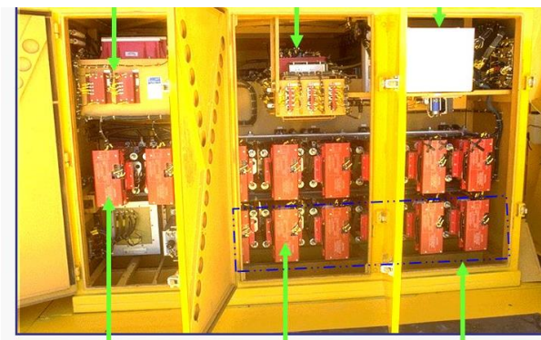
Ilustración 10: Gabinete de control.
