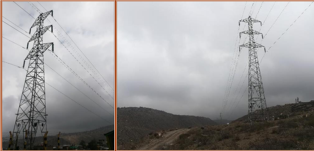
Figura 50. Línea de transmisión de 60 kV. Fuente: Elaboración propia
