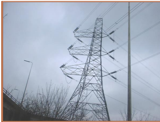
Figura 21. Apoyo de ángulo doble de doble terna.
