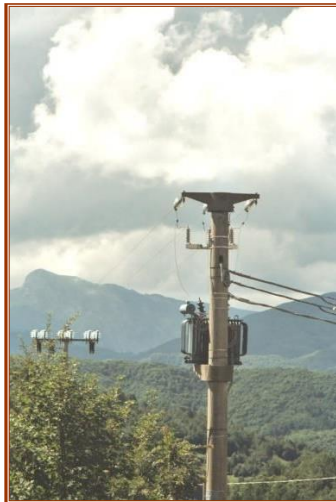
Figura 24. Apoyo especial de alta tensión a baja tensión.
