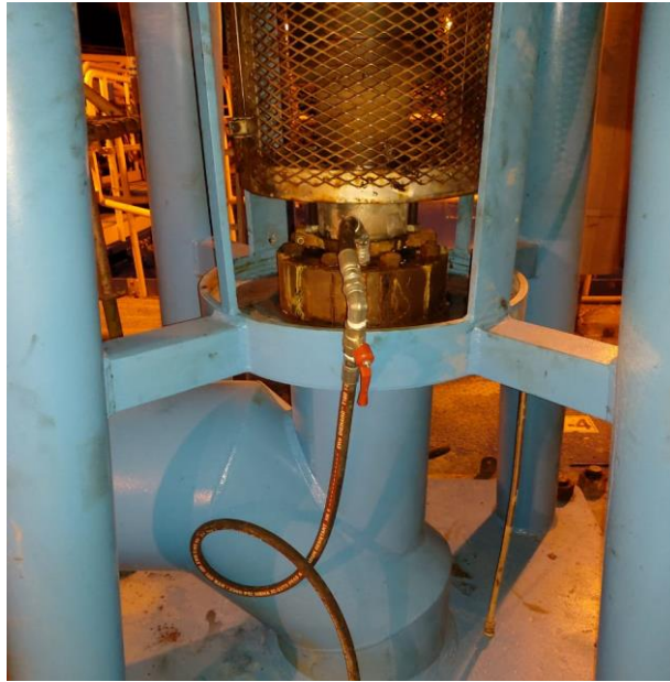
Ilustración 32: Mangueras y válvulas instaladas en bombas.
