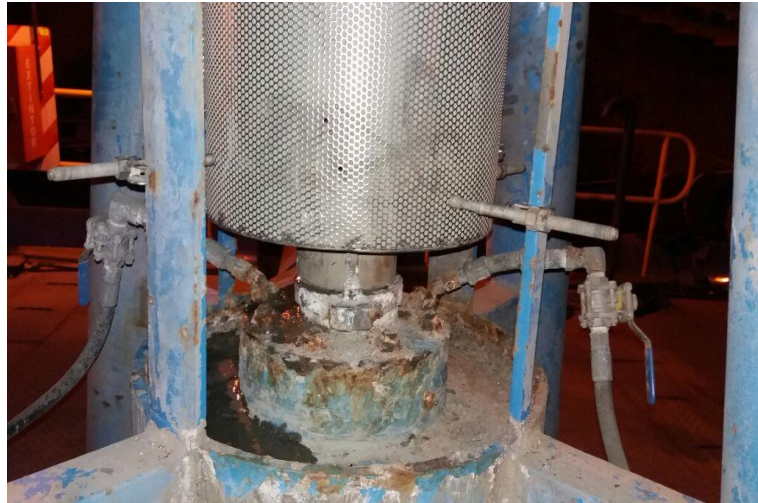
Ilustración 33: Estado de bombas sin limpieza. Fuente: Elaboración propia
