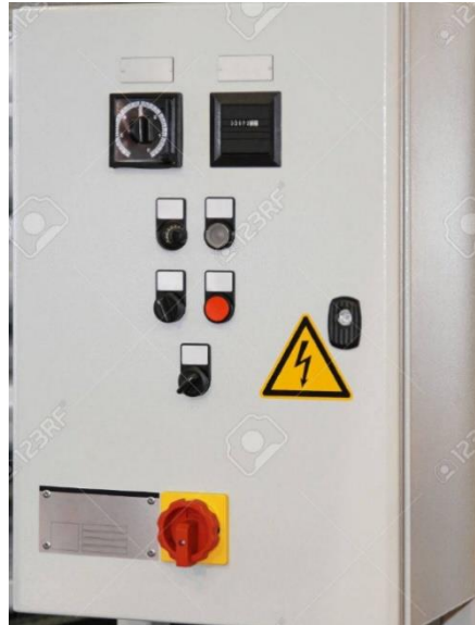
Figura 85. Tablero eléctrico, tomado de https://es.123rf.com/photo_31125264_caja-de-control-el%C3%A9ctrico-con-pulsadores-e-interruptores.html
