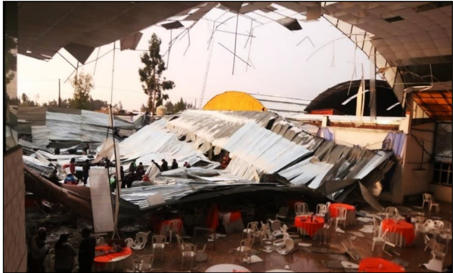
Figura 7: Caída del Techo en Salón de Recepciones dejó 6 muertos, Huancán. Fuente: El Comercio, 14 de Octubre del 2019.
