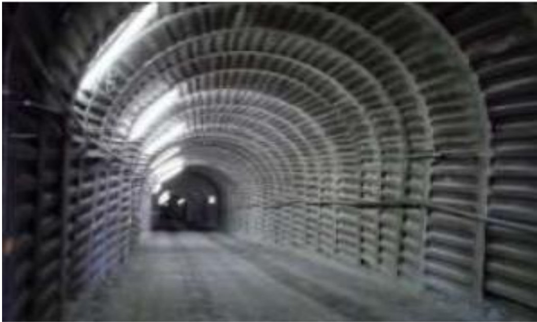
Figura 9. Sistema de cimbras para el sostenimiento de labores principales
