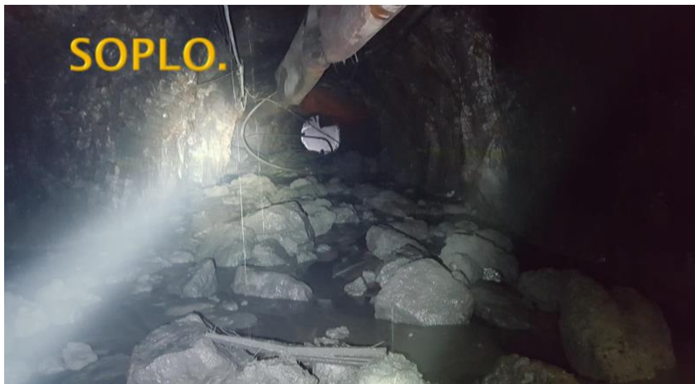
Figura 31. Soplo de mineral, producto de la inestabilidad del macizo rocoso
