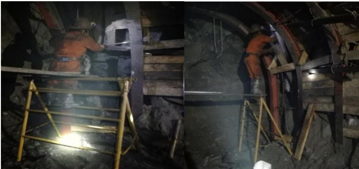
Figura 21. Iniciando el entablado, cariito y topes. A la derecha el encribado de cimbra, bolsacretes, bancos y materiales.
