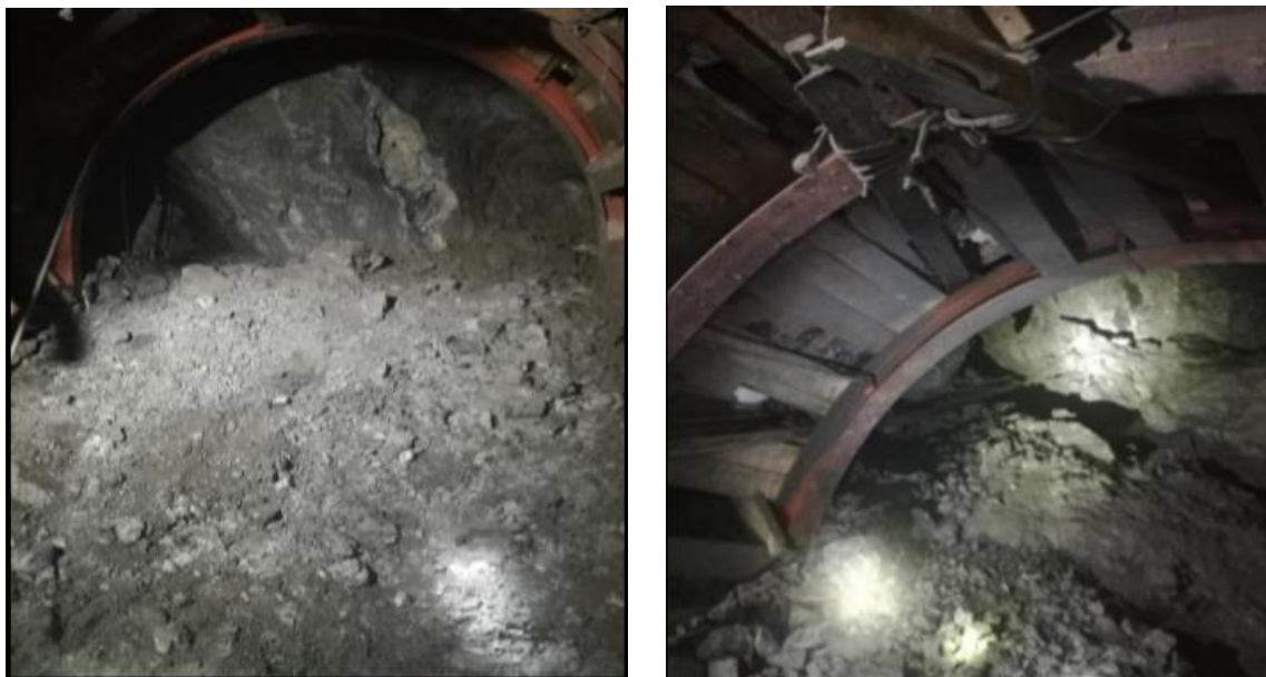
Figura 15. Frente disparado, desatado de rocas y a lado derecho la instalación de marchavantes de 45/60lbs. 6 a más
