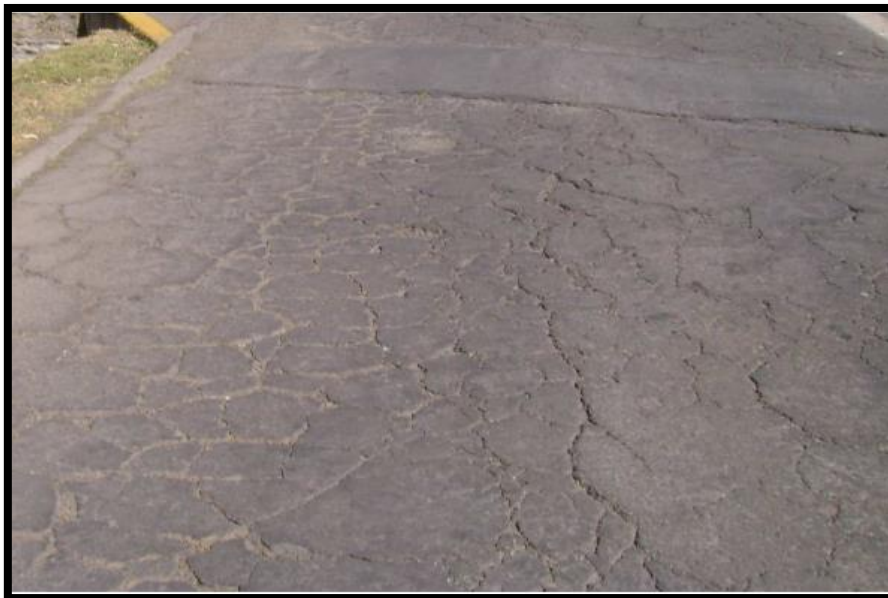
Figura 2: Fallas generadas por pérdida de adherencia y cohesión - Huancayo
