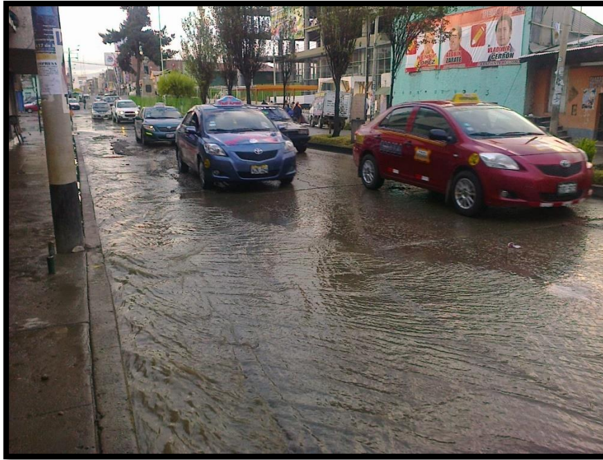
Figura 1: Pavimento expuesto a saturación de agua constante - Huancayo
