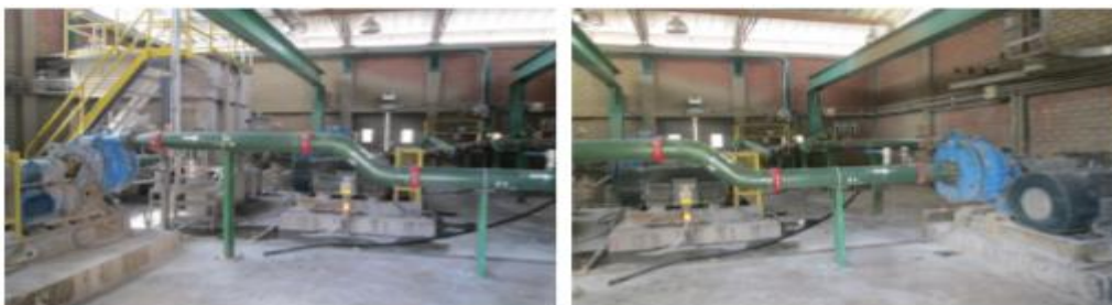
Figura 20. Cámara de bombas Goulds 6" x 4" 200 HP
