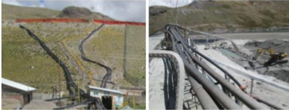
Figura 19. Desde las bombas Metso hasta los hidrociclones
