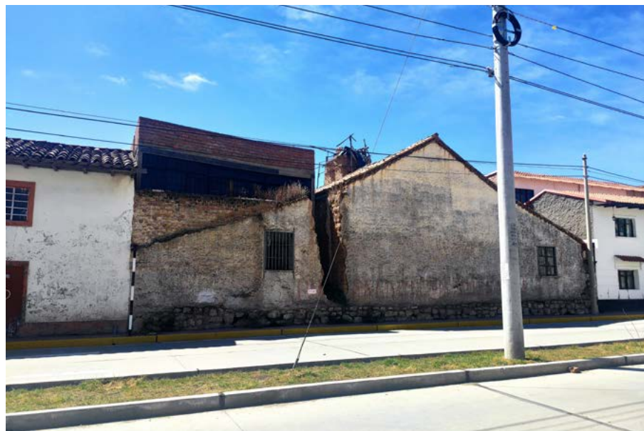
Foto 4. Estado actual del muro posterior desde la avenida Hatun Xauxa
