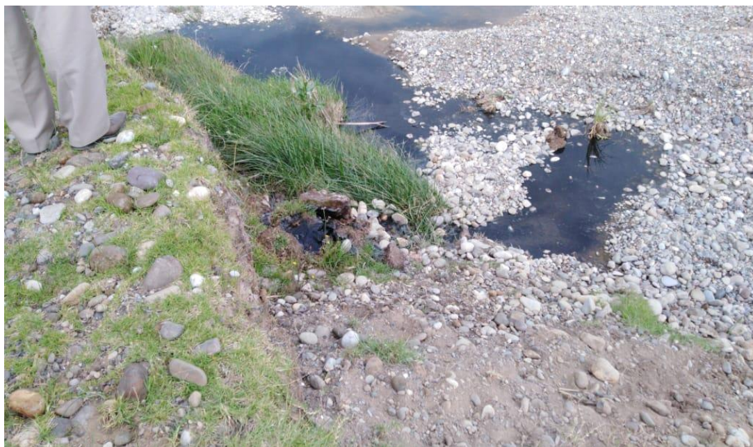
Punto de vertimiento del agua residual al cuerpo de agua río Mantaro.
