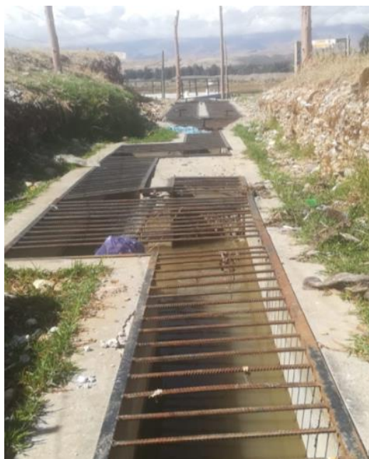
Pre tratamiento: cámara de rejas y desarenador.
