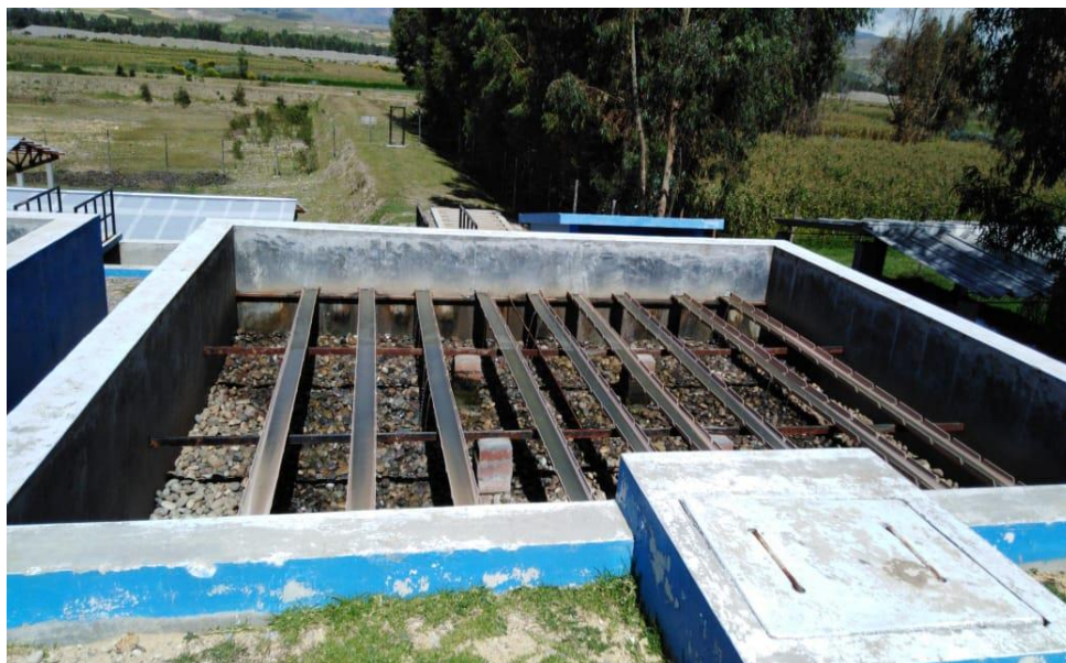
Tratamiento secundario: filtros biológicos.
