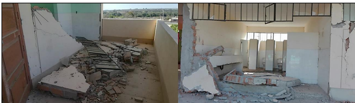
Figura N° 5: Fisuración y colapso de muros en el colegio “Francisco Flores” – Caravelí – 2018
