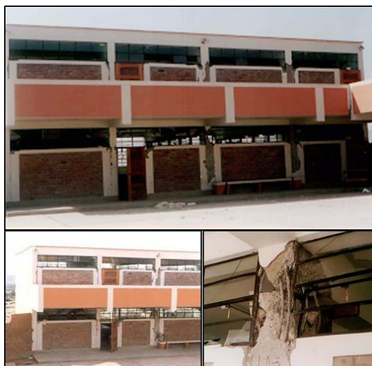
Figura N° 3: Fallas estructurales – I.E. “Colegio Fermín Del Castillo” – Nazca – 1996
