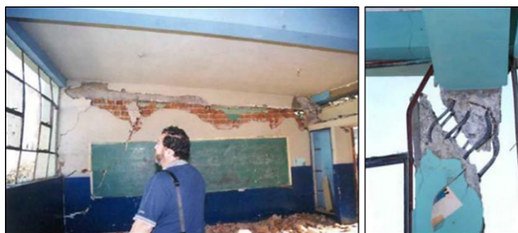
Figura N° 4: Fallas estructurales I.E. “Ángela Barrios” – Moquegua – 2001
