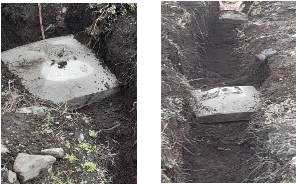
Figura 61. Bloques de concreto armado para evitar el hurto
