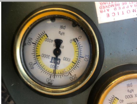
Figura 50. Presión de aceite de válvula reductora ok.
