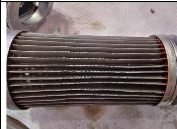
Figura 38. Filtro strainer limpio.
