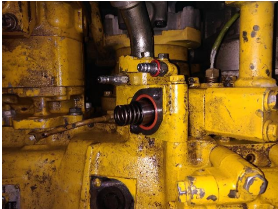
Figura 46. Mala instalación de válvula TC.
