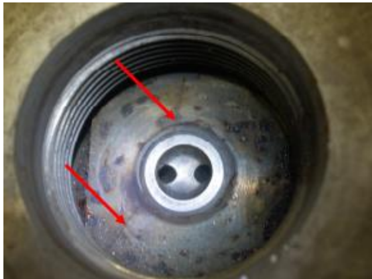
Figura 5. Vista agrietada de la bomba por la parte posterior.
