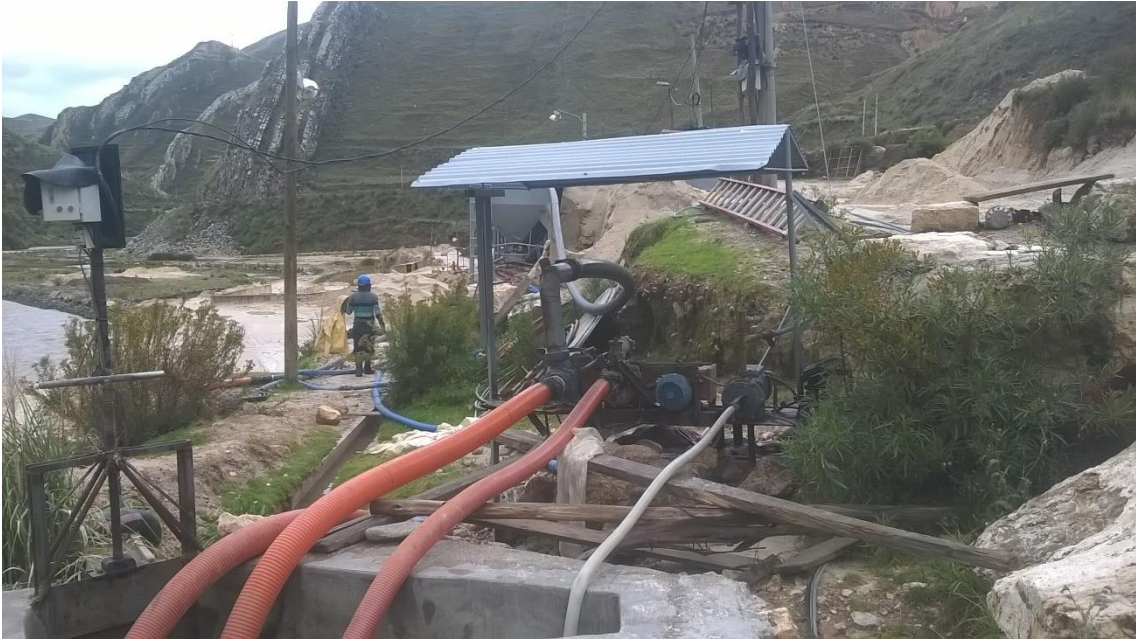
Anexo 06: Electrobombas de C.I.A. MINERA SIERRA CENTRAL
