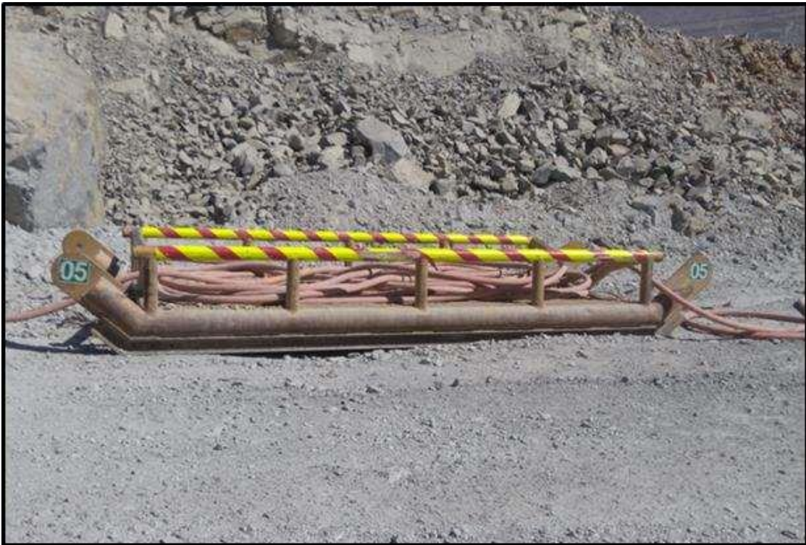
Figura 11. Cuna de cables de fuerza Fuente: Fotografía propia.
