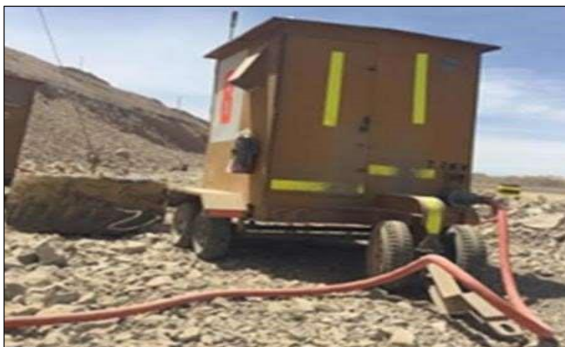
Figura 14. Casetas de energía eléctrica Fuente: Fotografía propia
