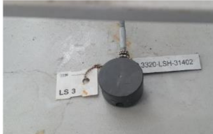
Switch de nivel de fuga de agua
