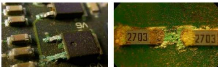
Fig2. Corrosión en tarjetas de control del VFD
