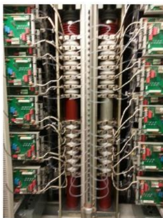
Sistema de enfriamiento por agua en los tiristores
