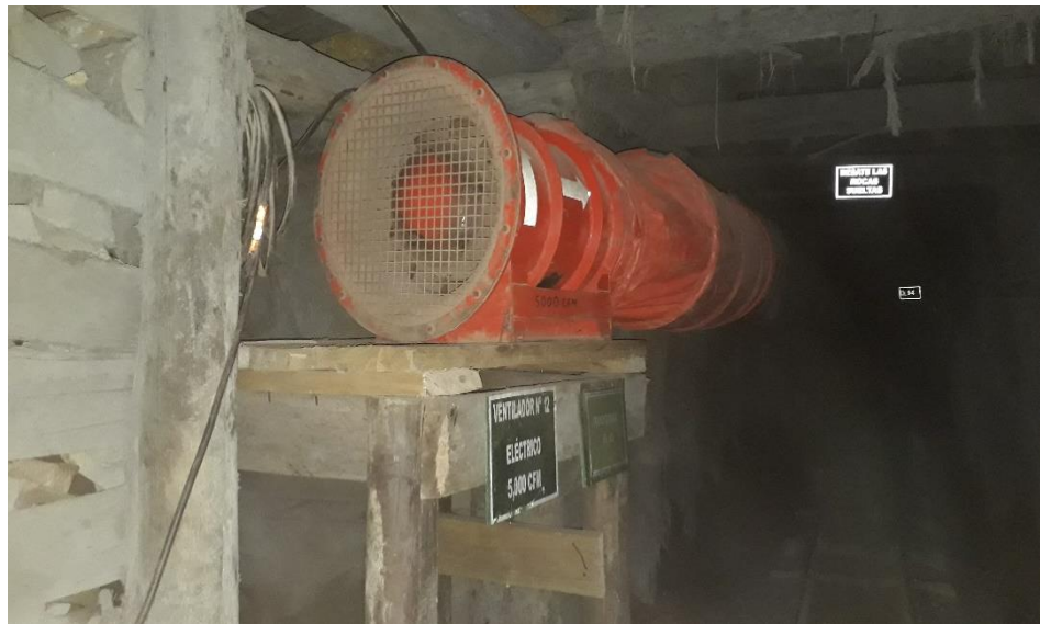
Ilustración 8: Ventilación de la labor con ventiladora eléctrica
