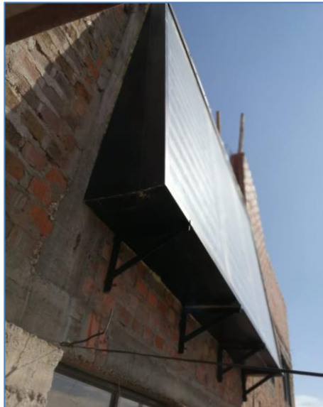
Figura 50: Vista inferior y soporte del colector solar térmico de aire. Fuente: Elaborado por los investigadores.
