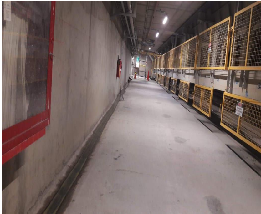
Ilustración 44: Iluminación LED túnel de faja transportadora Fuente: Propio
