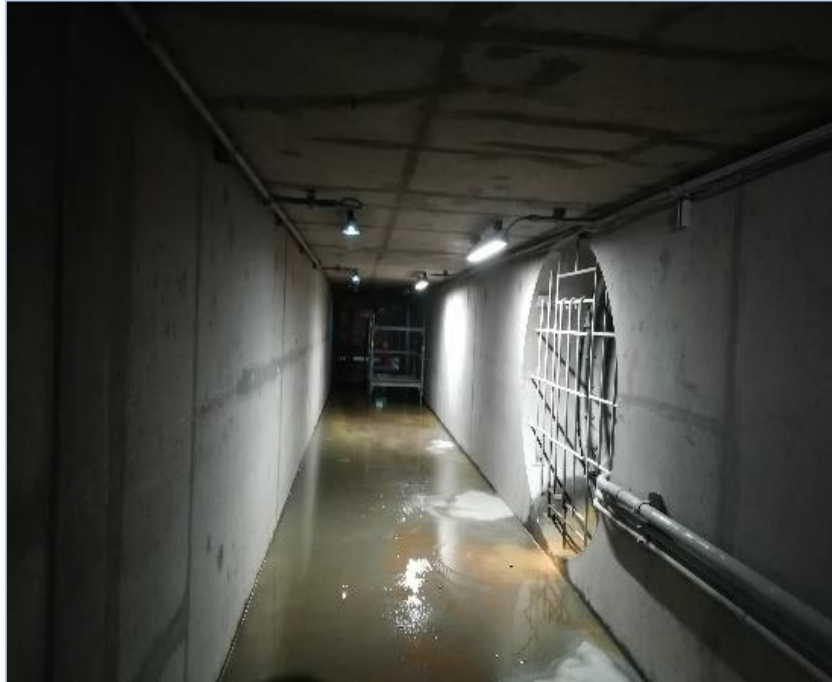
Ilustración 22: Iluminación deficiente en túnel de faja transportadora pasadizo.
