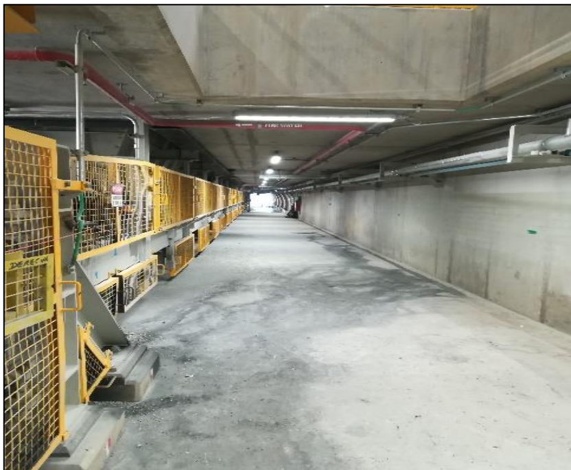
Ilustración 51: Túnel de faja transportadora 1er nivel
