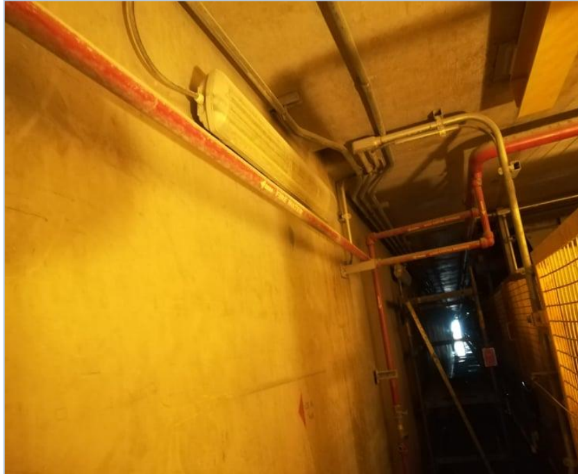
Ilustración 23: fluorescente instalados antes de la optimización
