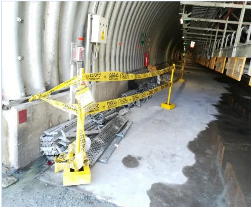
Ilustración 21: Iluminación Deficiente en túnel de faja transportadora ingreso
