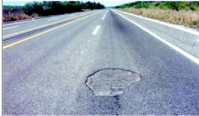
Figura M1.2. Desprendimiento de la última capa delgada
