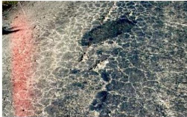
Figura M 1.3. Agrietamientos (Piel de Cocodrilo).
