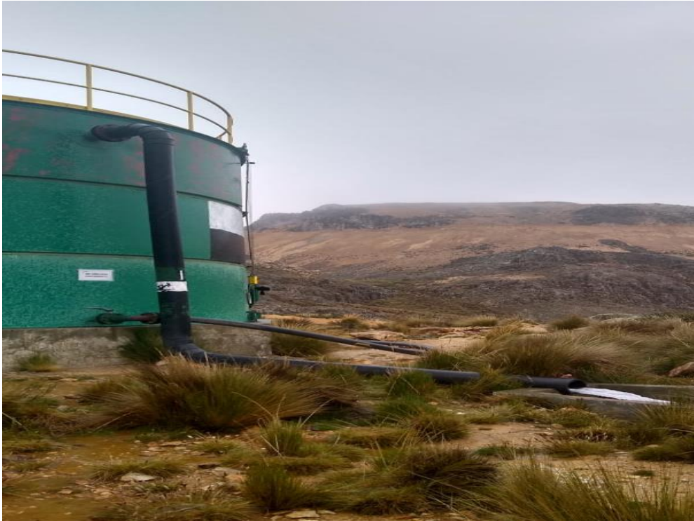
Figura 1. Pérdidas hídricas que se generan por el deficiente sistema de bombeo de agua potable
