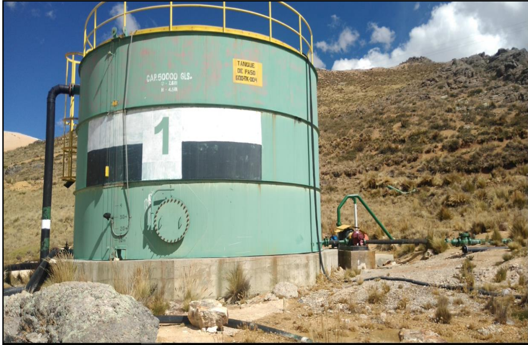
Figura 33. Tanque 1 con bomba centrífuga Fuente: elaboración propia
