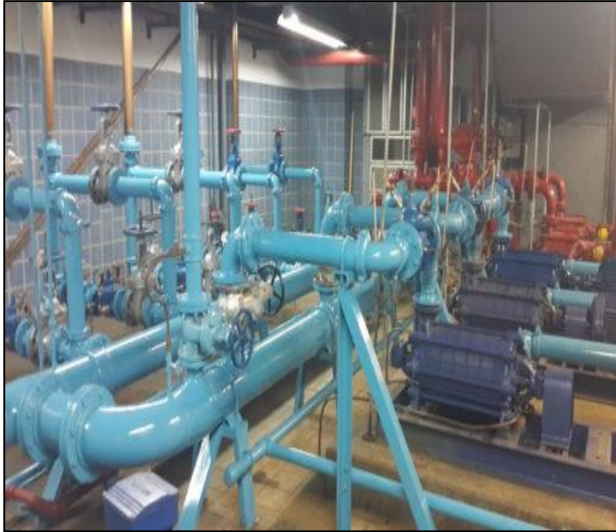
Figura 6. Sistema de bombeo de presión constante. Fuente: Tomado de Servicios y Proyectos Caspian.
