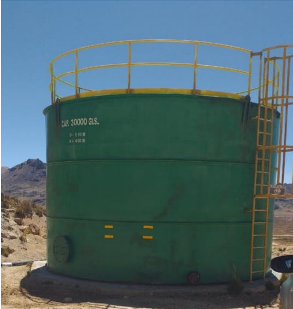
Figura 35. Tanque 3 de suministro a planta y campamentos Fuente: elaboración propia
