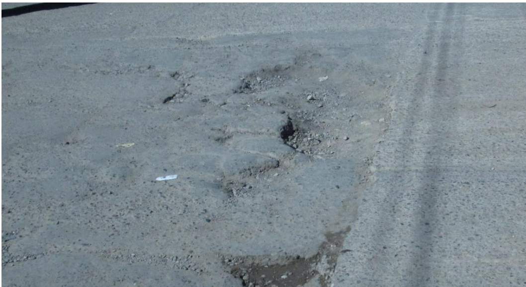
Figura 9. Reparaciones o parchados - Carretera Central
