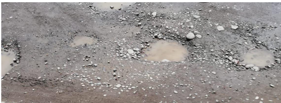
Figura 10. Baches (huecos) - Carretera Central
