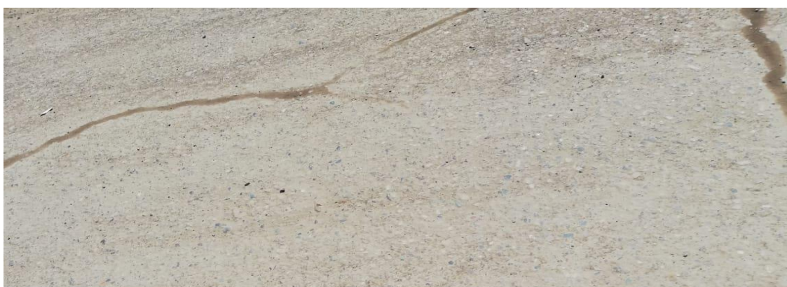
Figura 8. Fisuras longitudinales - Carretera Central
