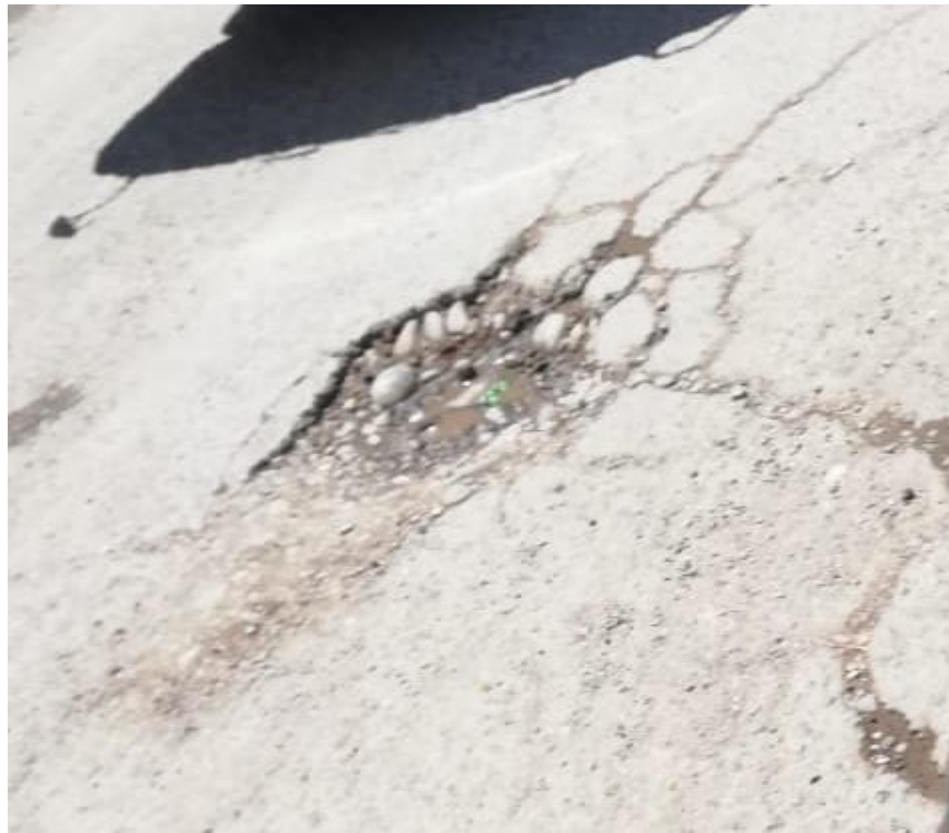
Figura 7. Piel de cocodrilo - Carretera Central
