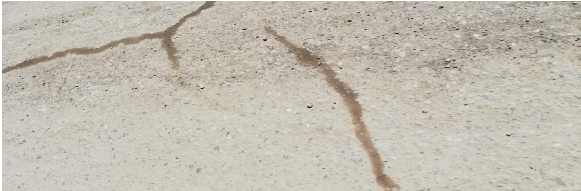
Figura 11. Fisuras transversales - Carretera Central
