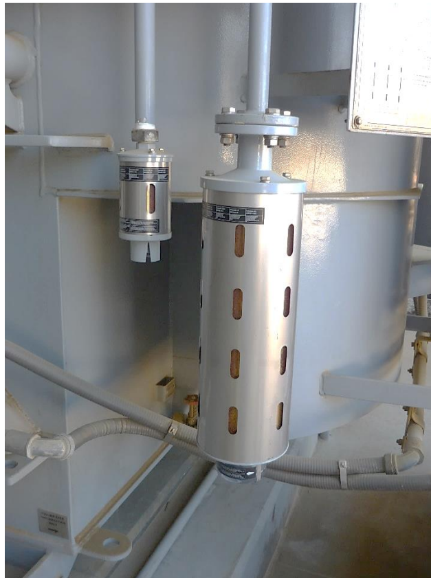
Figura 21: Posición embace de silica gel en el transformador de potencia
