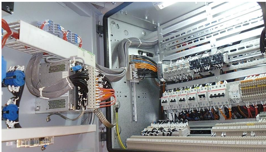
Figura 4: Tablero de control del transformador de potencia.
