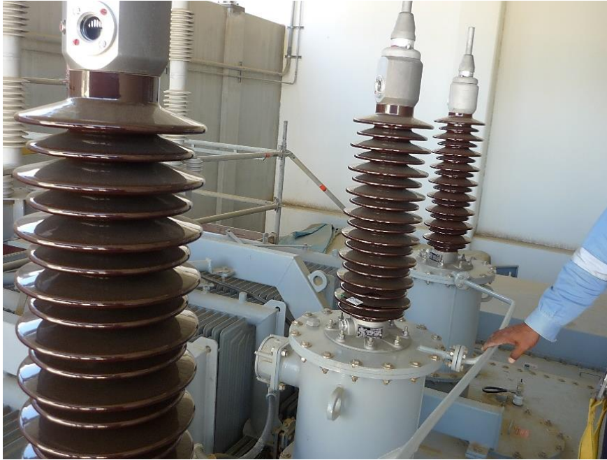
Figura 17: Posición los bushing del transformador de potencia
