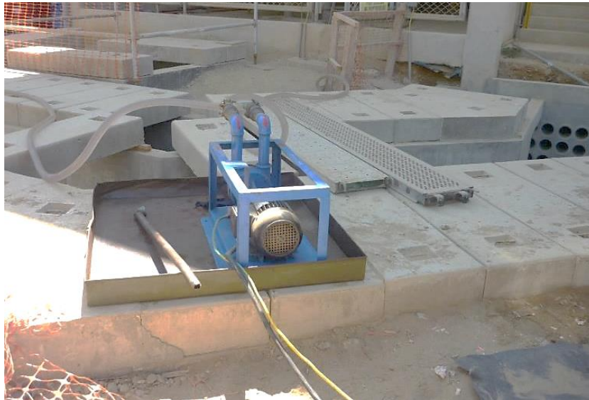
Figura 22: Trabajo de recirculado de aceite del transformador de potencia.
