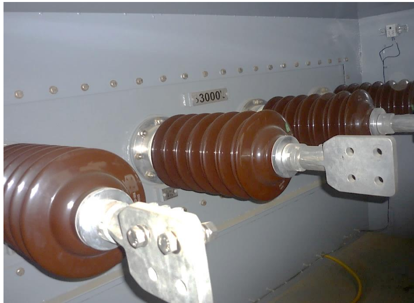
Figura 3: Bushing del transformador de potencia.
