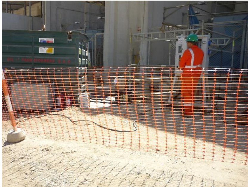
Figura 23: Almacenamiento de aceite del transformador de potencia en el tanque cisterna
