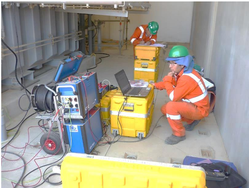
Figura 26: Pruebas Tangente delta en el transformador de potencia
