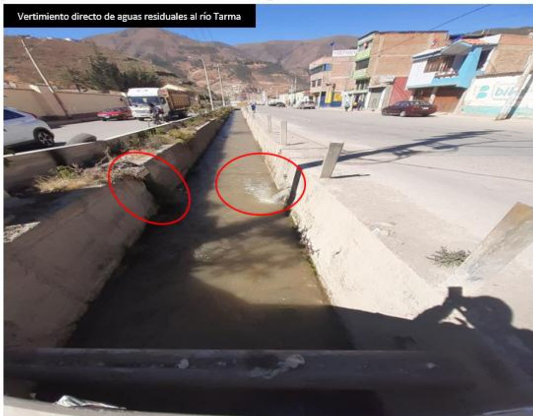
Fotografía 36: Vertimientos directos de aguas residuales al río Tarma.
