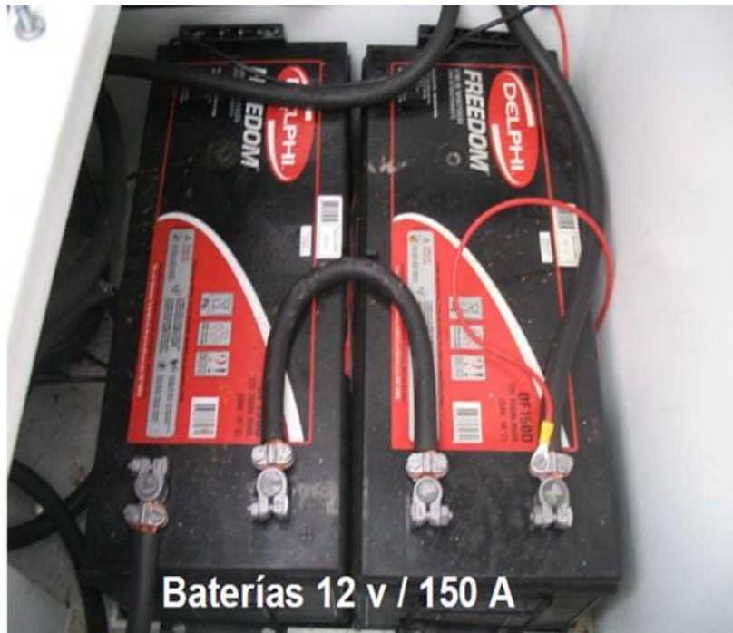
Figura 59. Baterías 12v/ 150A
